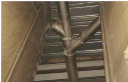
Ontluchtingsleiding naar centraal filter
