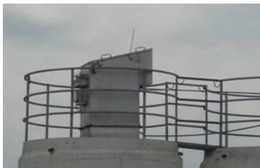
Ontluchtingsfilter op silo (zuigend)
